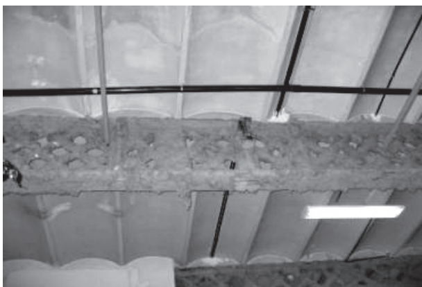
Figura 4. Amianto proyectado en estructura metálica (crocidolita)
